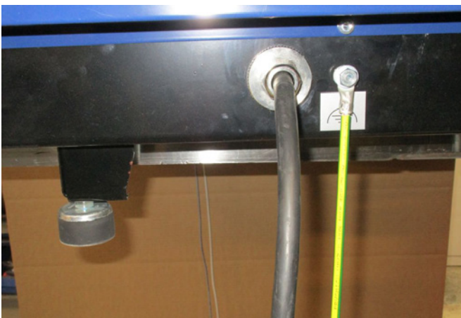
2 - Il cavo di potenza è posto attraverso il pressacavo sulla base del ventilatore lato destro (visto dal lato motore). Il cavo di terra è installato e fissato alla destra del cavo di potenza.
