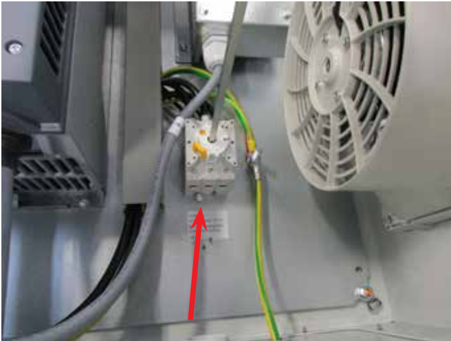
15 - Das Netzanschlusskabel wird wie aufgezeigt an den Hauptschalter angeschlossen.
