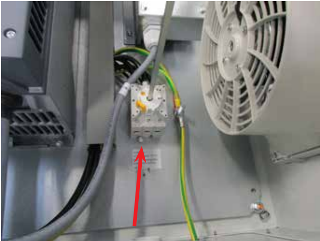
15 - Le câble de puissance est connecté à l'interrupteur principal, comme indiqué sur la photo.
