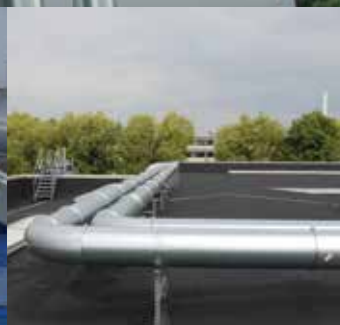
| Sistema de conductos
