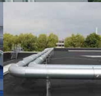
| Systèmes de tuyauteries
