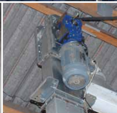
Hlava elevátoru s převodovým motorem.
