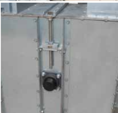
Napínání řemenu s korečky přestavením kola v patě elevátoru.
