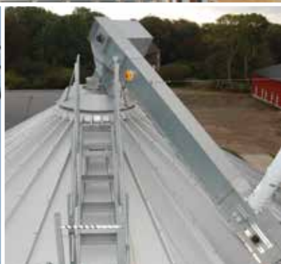
Na střechu sila namontovaný řetězový dopravník s krytem nad převodovým motorem.
