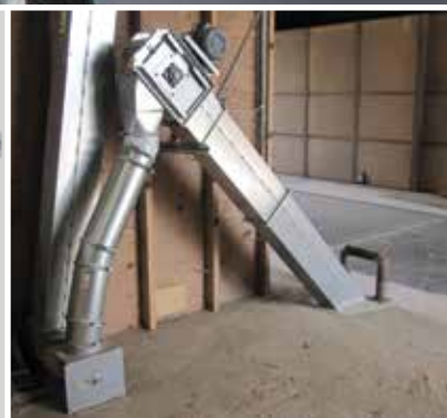
Řetězový dopravník dopravuje obilí z příjmového koše do paty FLEX dalšího elevátoru.
