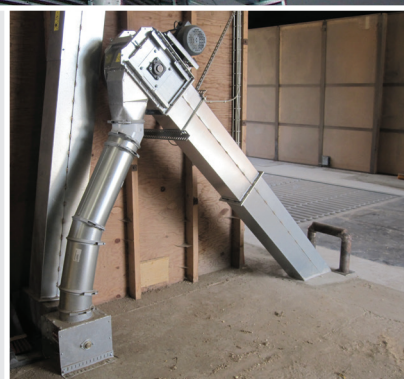
L'élévateur à chaîne transporte le grain depuis la fosse vers le pied "flexible" de l'élévateur suivant.
