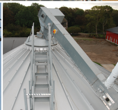
Conveyeur à chaîne sur silo avec protection du motoréducteur.
