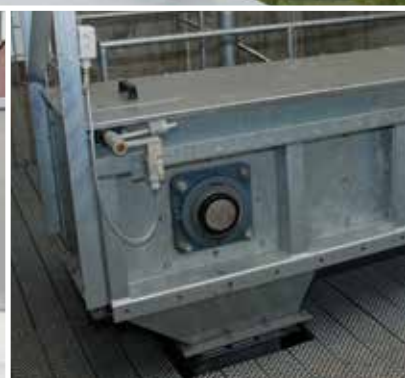
Træksektion med udløb og overløb. Overløb monteret med switch.
