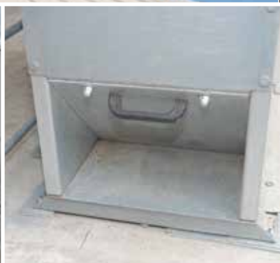
Adgang til tømning af elevatorfod.
