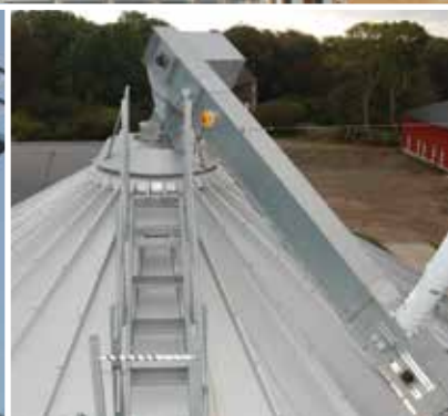
Kædetransportør monteret på silotag. Regnskærm over gearmotor.
