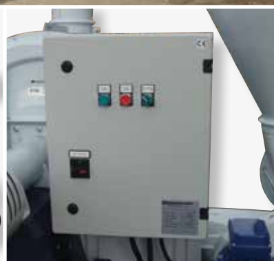
Schaltschrank für automatisches Ein-/Ausschalten des Motors.
